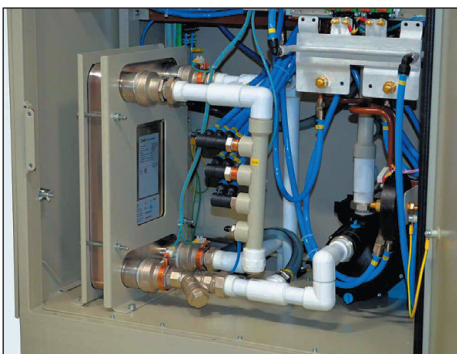
Рис. 7. Теплообменная станция преобразователя частоты
