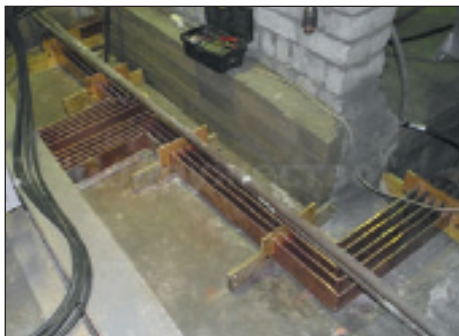
Рис. 15. Силовые шинопроводы ТВЧ
