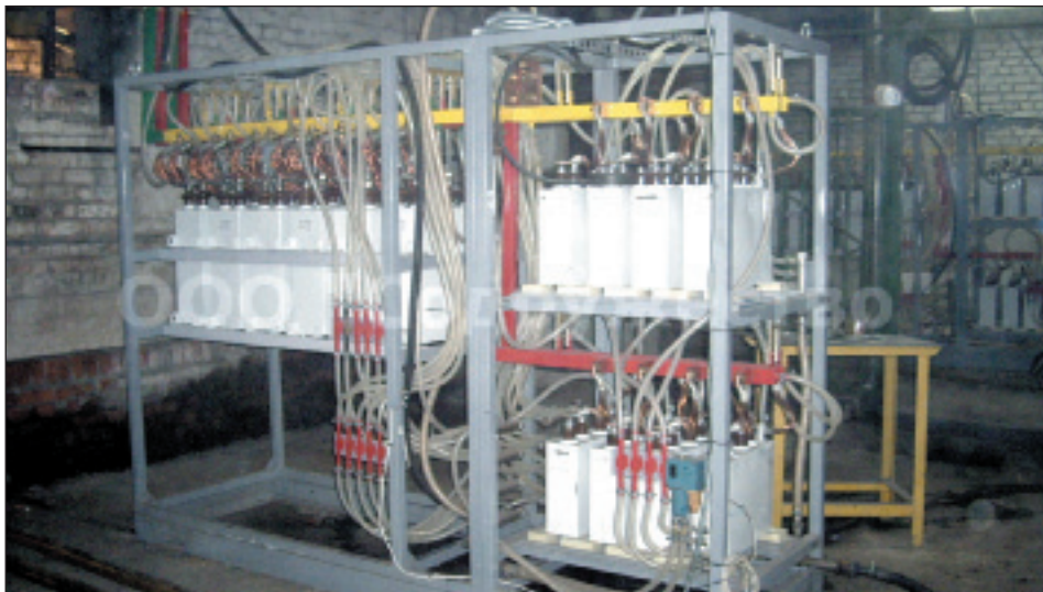
Рис. 17. Конденсаторная батарея для индукционной печи
