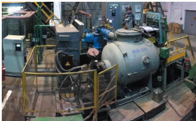
Рис. 9. Установка индукционного оборудования вакуумной печи ИСВ-0,04 с преобразователем ПЕТРА-0132
