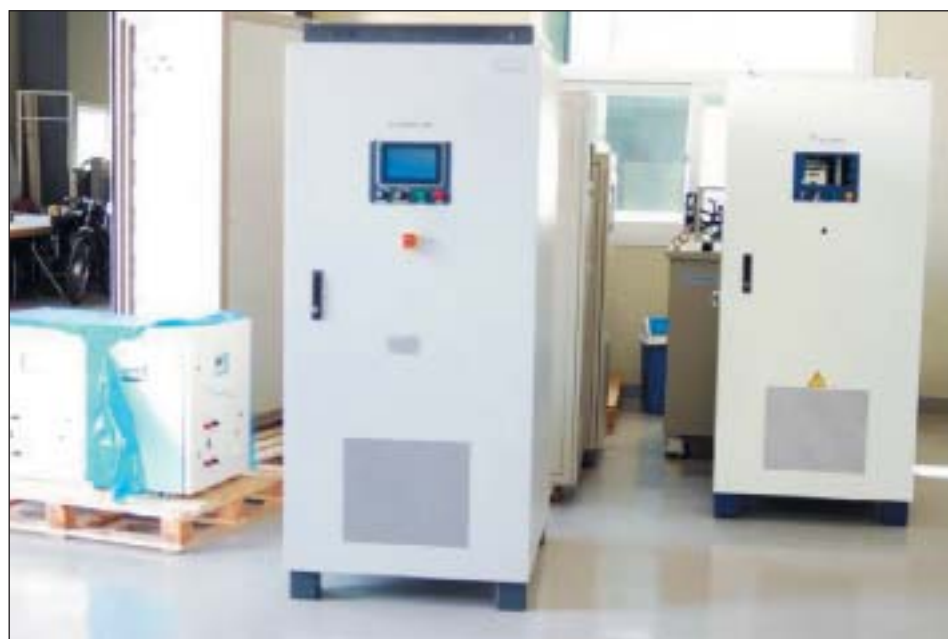
Рис. 3. Преобразователи на складе. Связь — Ethernet или CAN. Функции защиты: ключ нештатной ситуации; определение тока утечки; защита от молнии; защита по входному току (DC); защита по выходному току (AC); защита от перегрева и открытых дверей
