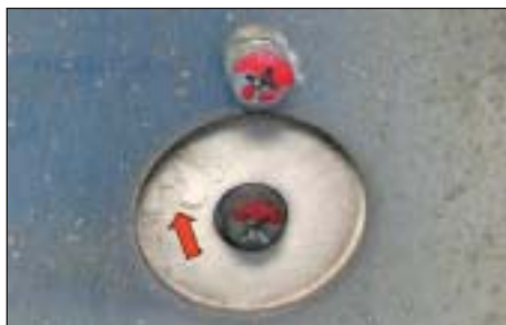
Рис. 7. Следы присутствия жидкости на изоляции DC-шины
