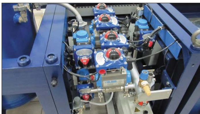
Рис. 4. Группа пневматических переключателей
