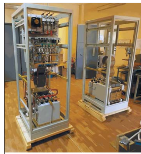
Рис. 12. Стойки ППЧ-320-2.4 с силовыми узлами
