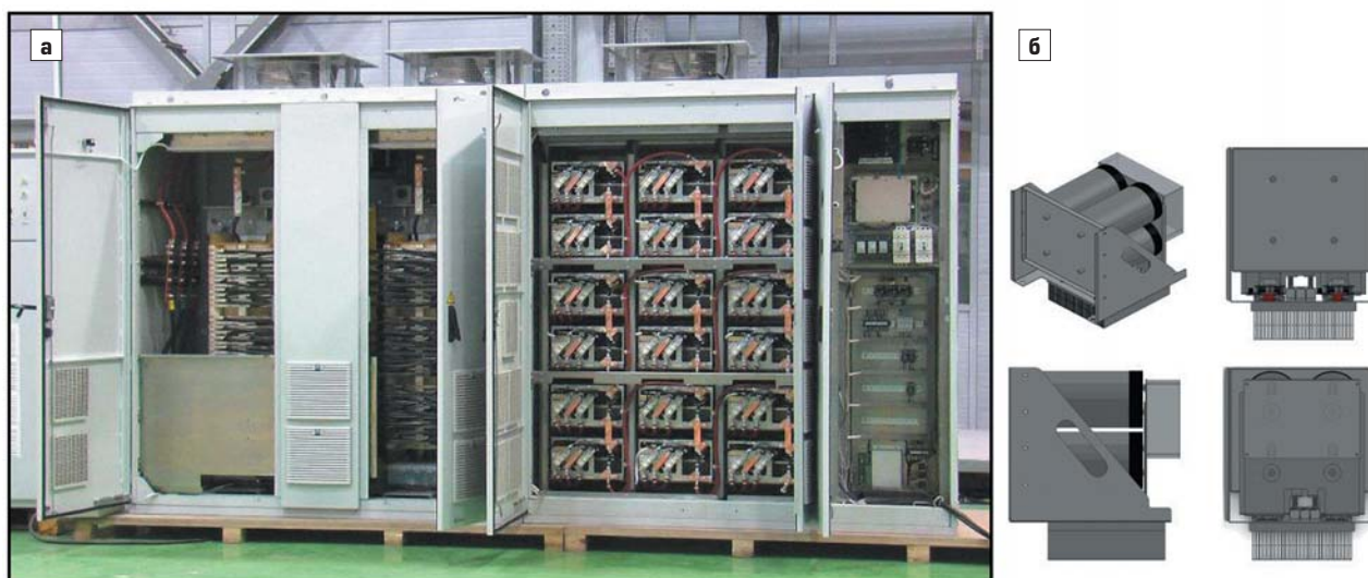
Рис. 12. а) готовая MV-система (1,3 МВт, 3 кВ); б) внешний вид MLI-ячейки SEMİKRON (200 А),
