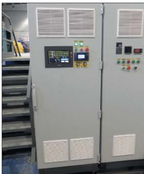
Рис. 18. Внешний вид НПЧ и шкафа водяного охлаждения
