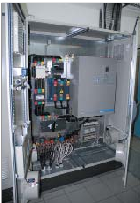
Рис. 2. Шкаф с частотным преобразователем, фильтрами и коммутационными устройствами
