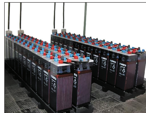
Рис. 11. Фрагмент подстанционной батареи на номинальное напряжение 230 В, состоящей из 106 последовательно соединенных свинцово-кислотных аккумуляторов с положительными электродами Планте
