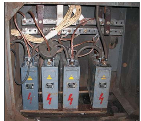
Рис. 12. Батарея компенсирующих конденсаторов колебательного нагрузочного контура
