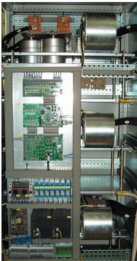
Рис. 2. Внешний вид шкафа с автономным инвертором напряжения
