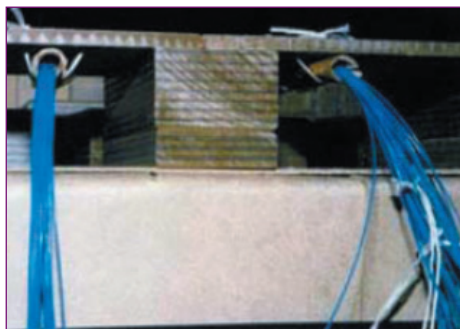
Рис. 7. Оптоволоконный кабель на выходе из обмотки
